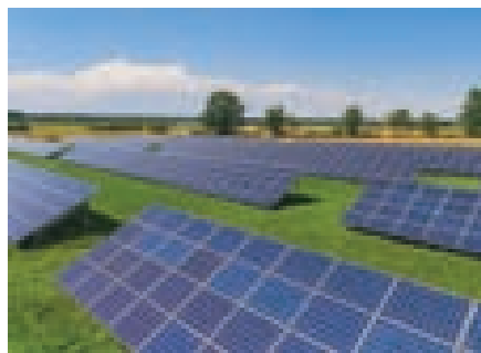
Рис. 105. Брагинская солнечная электростанция
