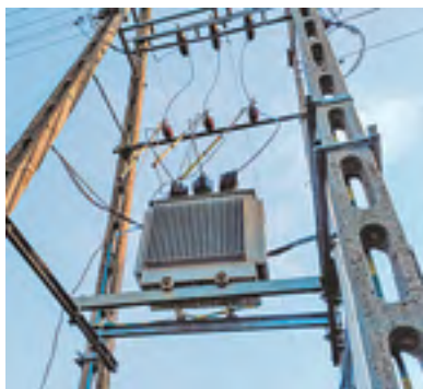
Рис. 67. Трансформатор с масляным охлаждением
