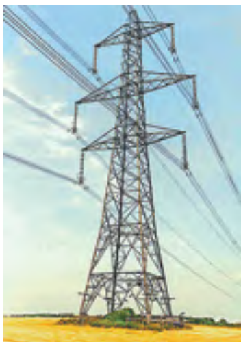
Рис. 68. Высоковольтная линия электропередачи
